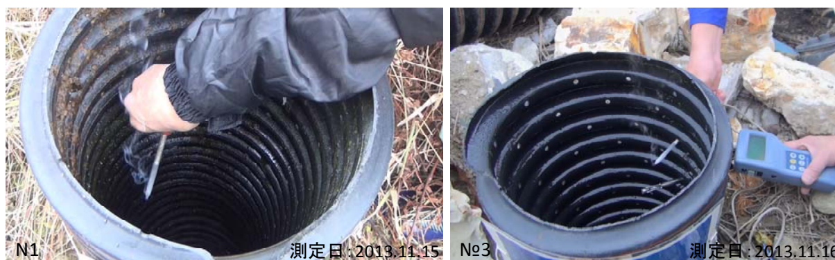
(b) ガスが流出しているガス抜き管 (No3、N1)
